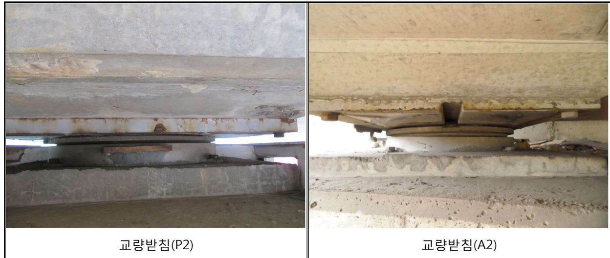
<사진 3.8> 교량받침의 결함 및 손상현황
