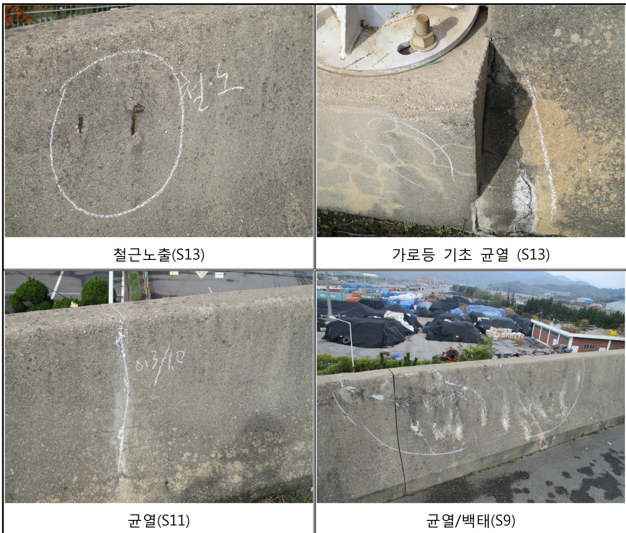
<사진 3.2>방호벽 결함 및 손상현황
