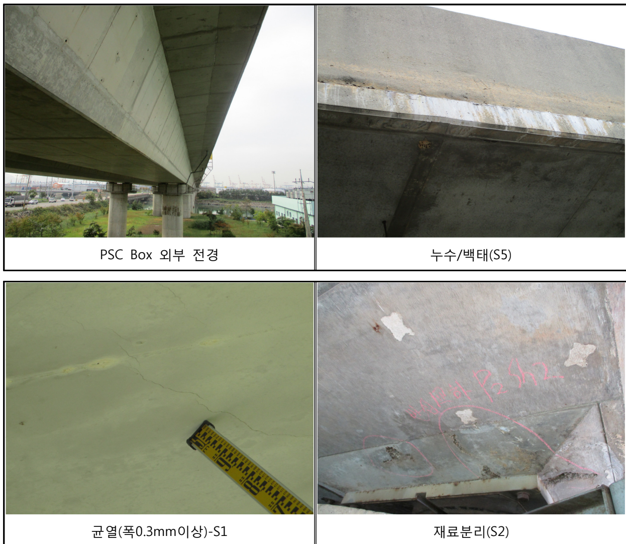
<사진 3.6> 바닥판 하면의 결함 및 손상현황
