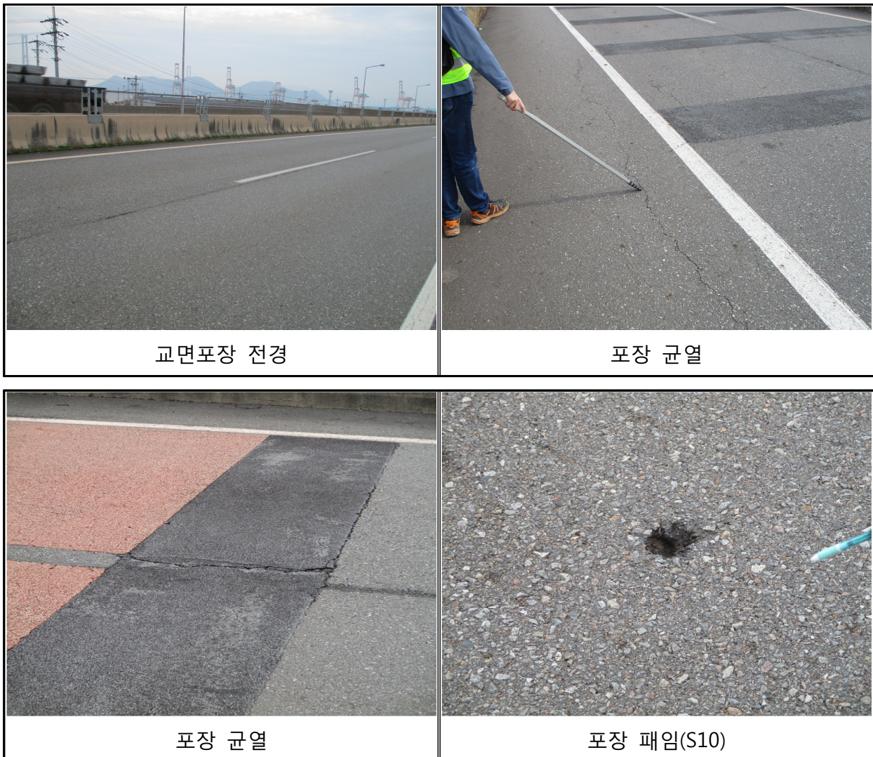
<사진 3.1>교면포장의 결함 및 손상현황
